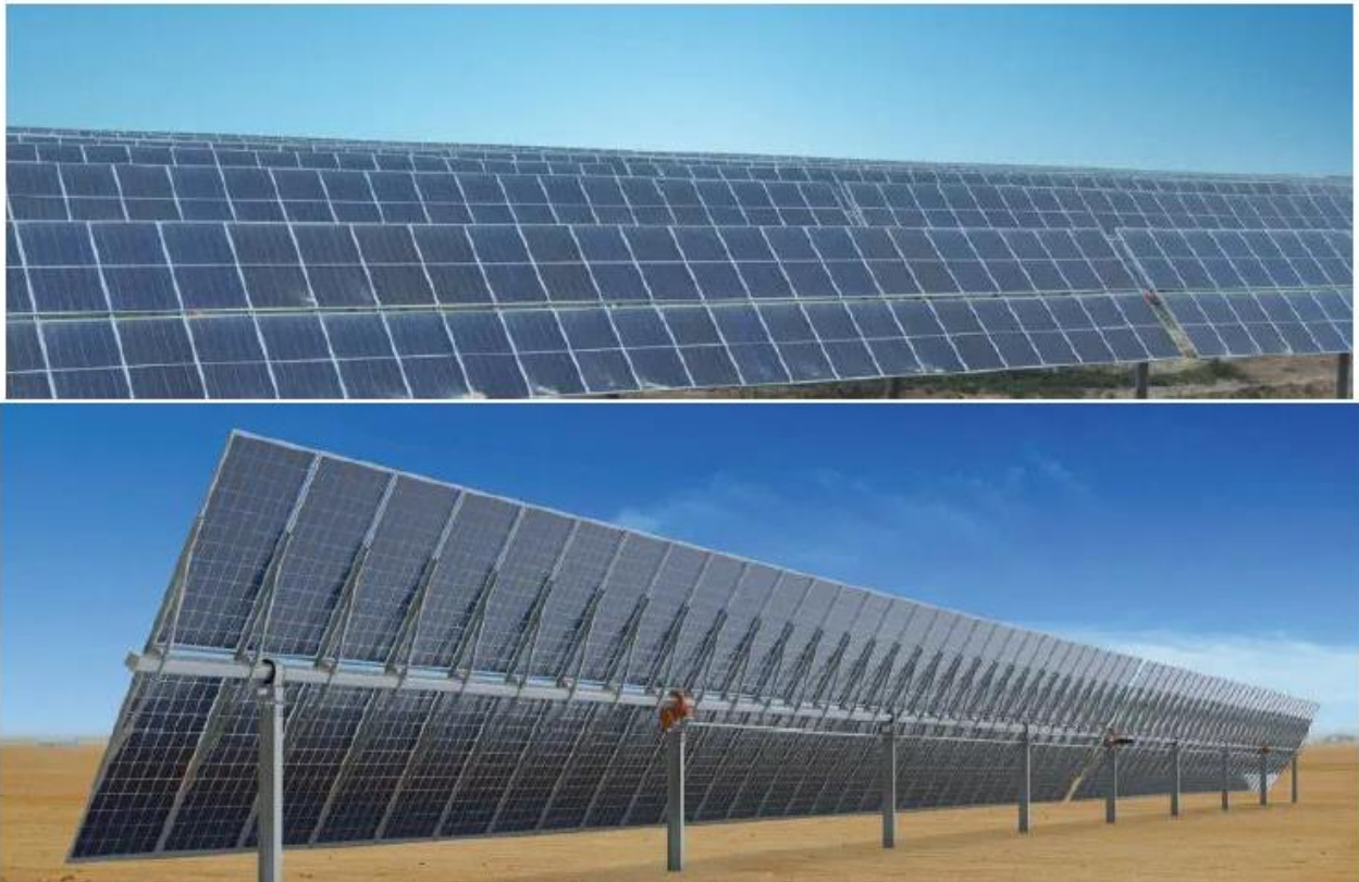
Figura 3: Esempio di inseguitori monoassiali
